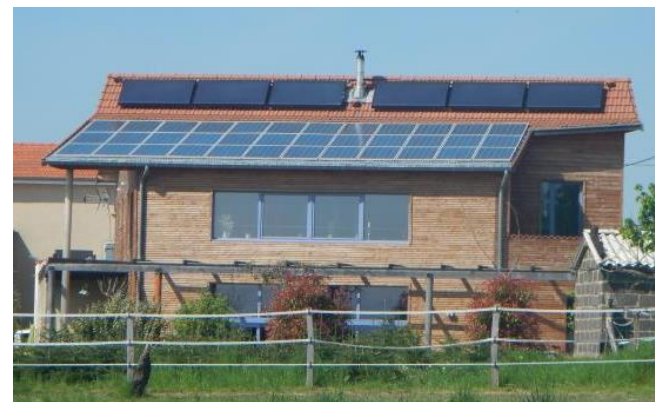
Un exemple d'installation photovoltaïque pour le résidentiel à Chaponost
